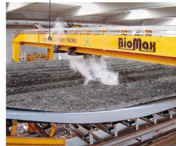
Ponte Rolante para revolvimento do material
