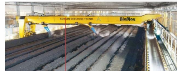
Detalhe da Ponte Rolante
